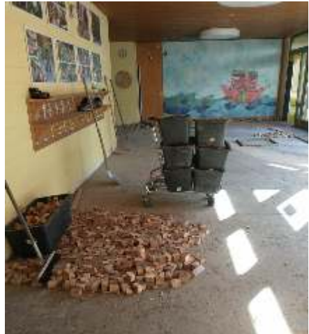
Schaden in der Kita Melanchthon
