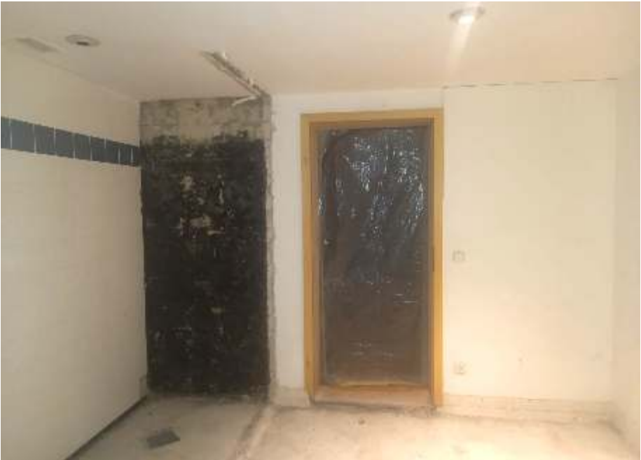
Die zukünftige Küche. Herr Martin hat den bisherigen Abstellraum in tagelanger schweißtreibender Arbeit vorbereitet. Danke! (Foto: Jörg Cremer)
